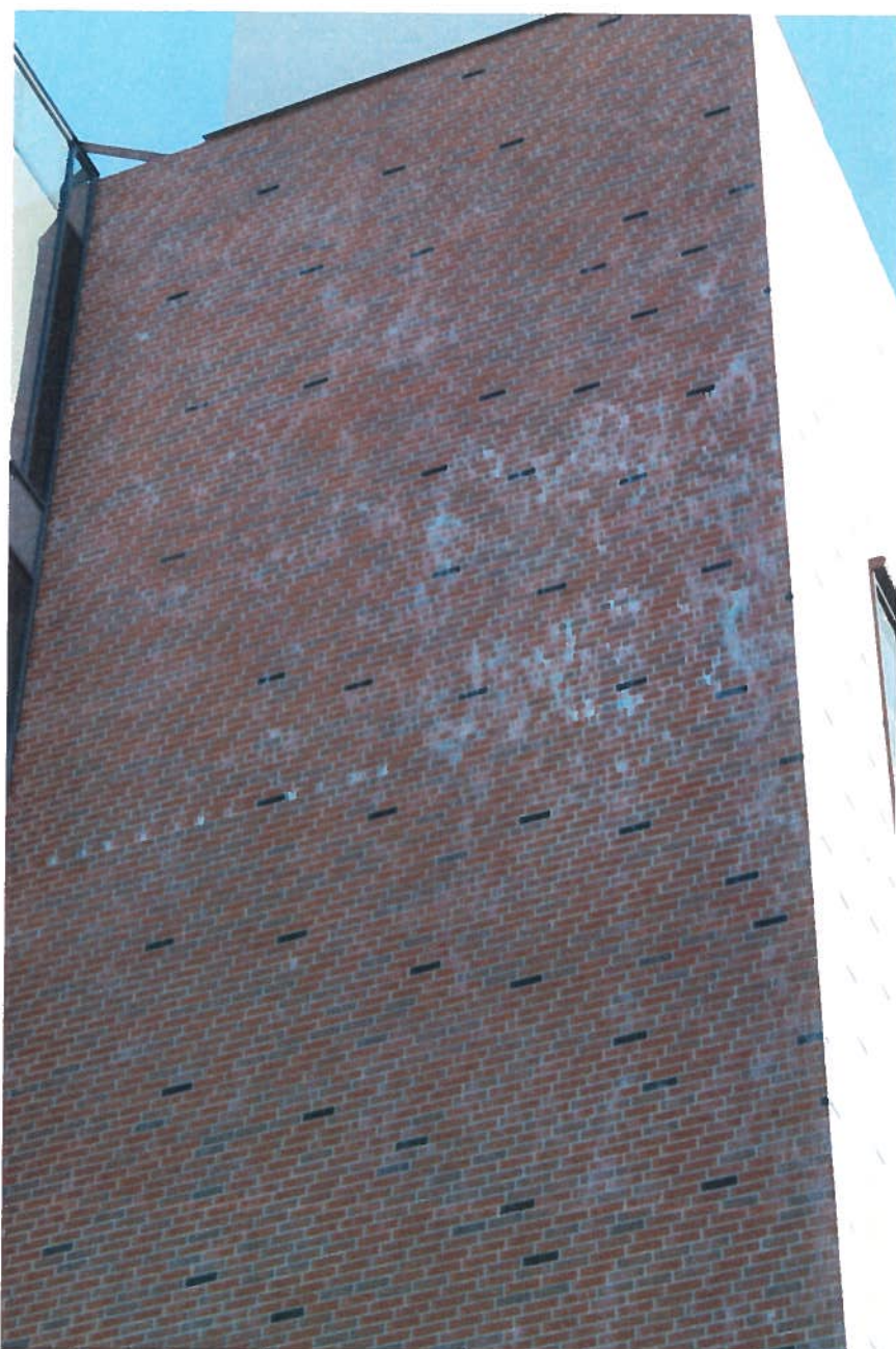
Fot. nr 48 Skutki wypłukania zapraw klejowej i/lub fugowej - elewacja środkowo-zachodnia (03.01.2014 r. r.)
