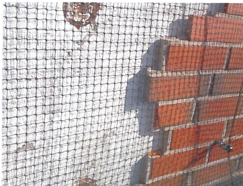
Fot. nr 38 Odspojone płytki elewacyjne w punkcie kontrolnym nr 20
