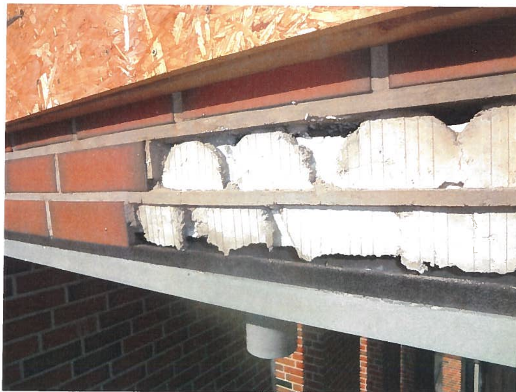
Fot. nr 33 Punkt kontrolny nr 17 - wadliwie zamontowane płytki na wejściu
