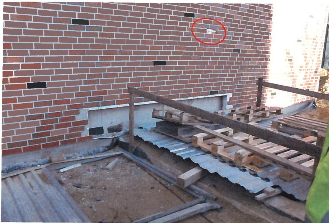
Fot. nr 45 Przykład odspojenia pojedynczej płytki z klejem od podłoża (03.01.2014 r.)
