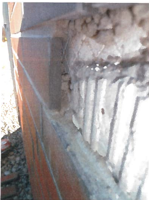
Fot. nr 40 Widoczne braki kleju mocującego płytki
