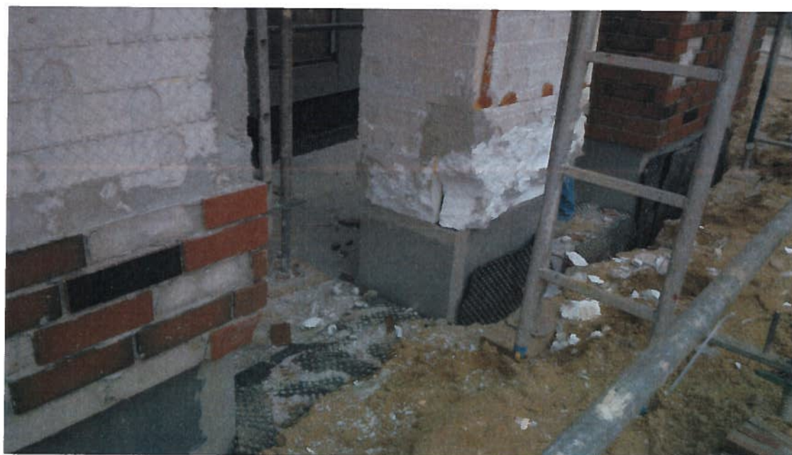
Fot. nr 46 Przykład odspojenia kilku płytek od zaprawy klejowej (25.09.2014 r.)
